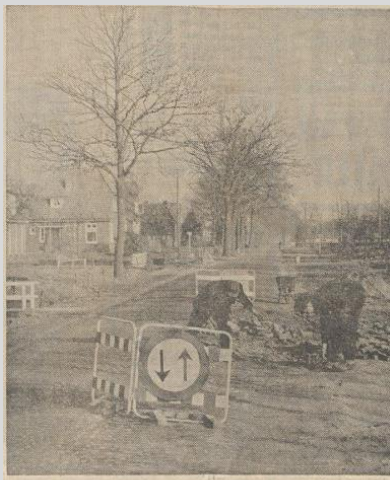
Boijlerweg; het hele jaar door borden, hekken, straatmakers, stenen, zand en... weggebruikers.
